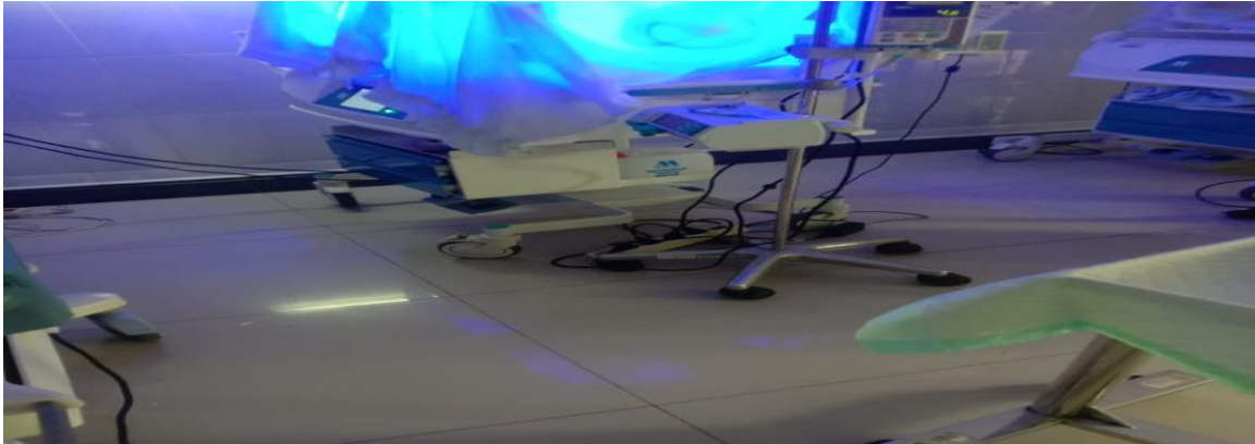
Gambar 5. Ruang VK yang mana kabel terminal saling menyatu yang mengakibatkan resiko konsleting listrik dan dapat kena dengan pasien maupun staf yang bertugas
