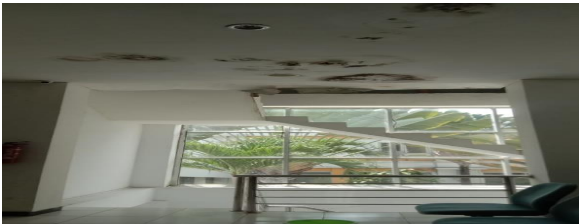
Gambar 6. depan ruang Yanmed beberapa pelapon bocor mengakibatkan lantai licin yang berisiko staf atau pasien dapat terjatuh
